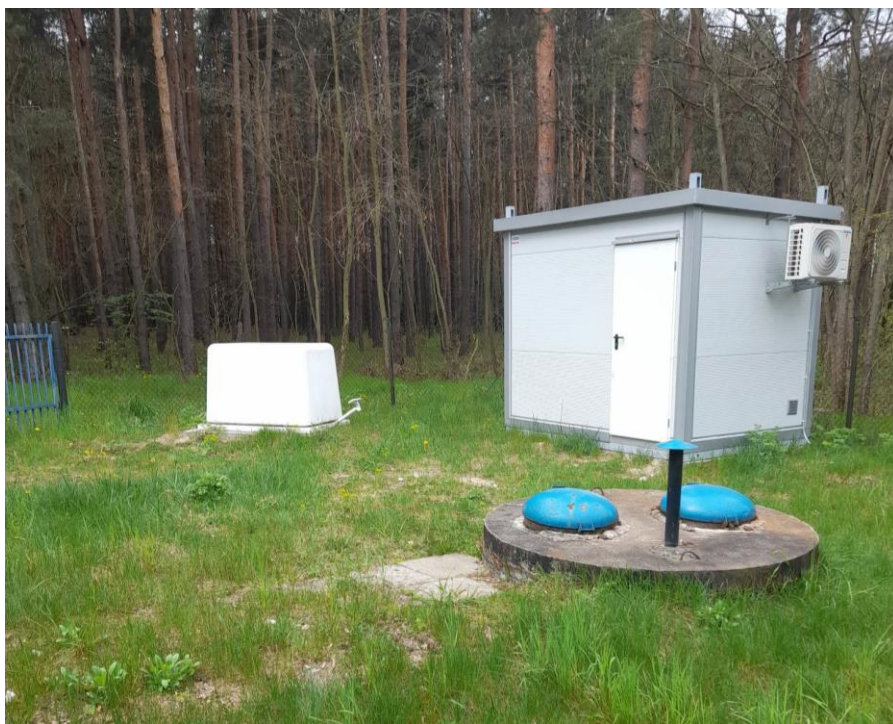
Fot. Ujęcie wody w Zagajowie z widoczną studnią zasadniczą S-1, awaryjną S-2 oraz budynkiem kontenerowym - sterownią.
