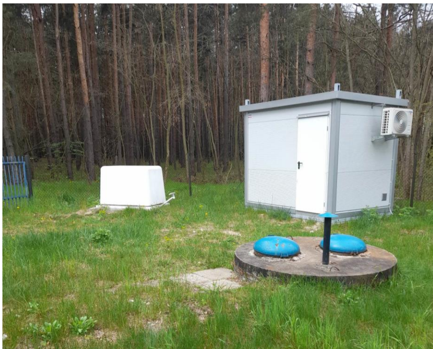
Fot. 1 – Ujęcie wody w Zagajowie z widoczną studnią zasadniczą S-1, awaryjną S-2 oraz budynkiem kontenerowym - sterownią.
